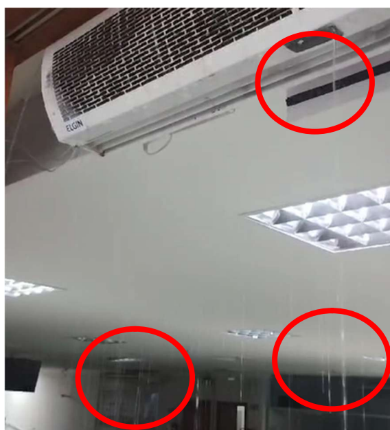
Figura 4 - Vazamentos no teto
