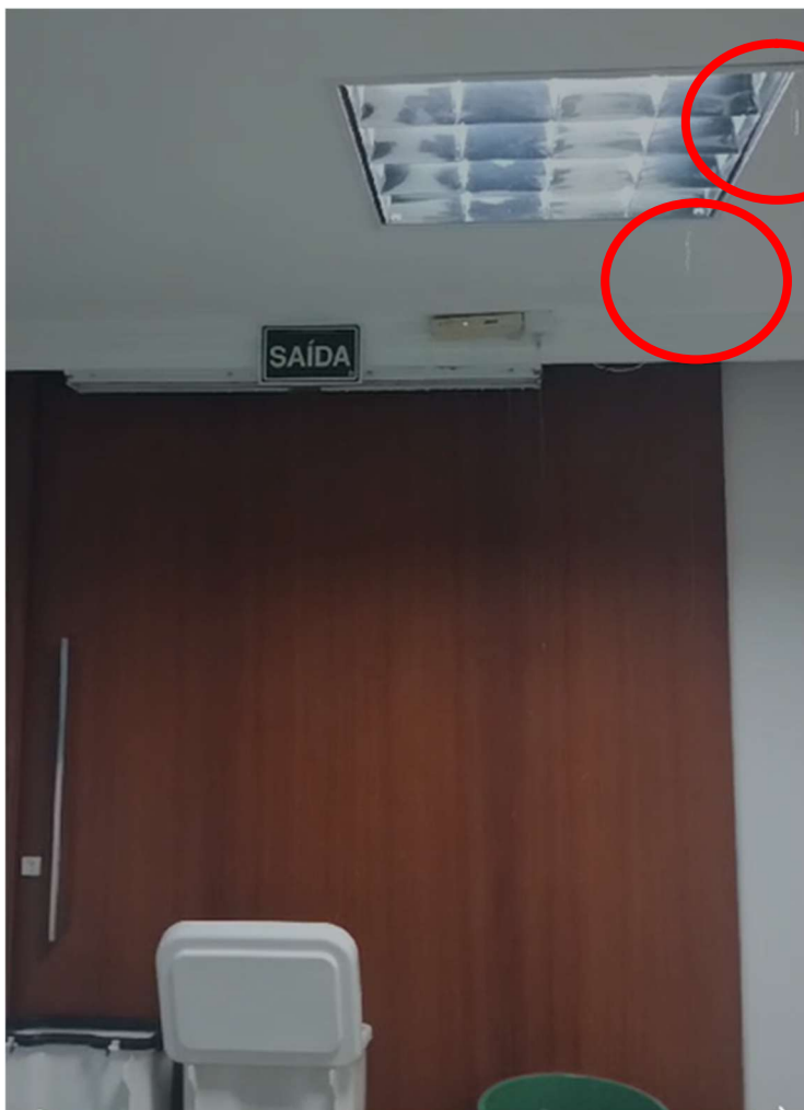
Figura 3 - Vazamentos no teto
