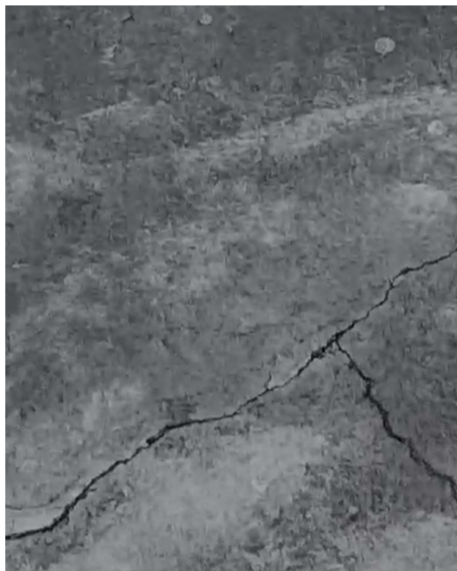
Figura 1- Trincas no teto
