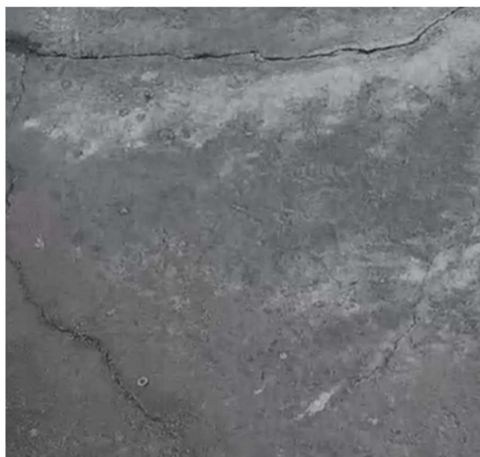
Figura 2- Trincas no teto
